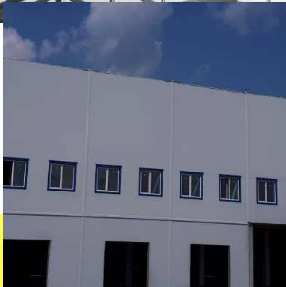
СКЛАДСКОЙ КОМПЛЕКС КЛАССА "А" Г. ЕКАТЕРИНБУРГ, УЛ. НИКОЛЫ ТЕСЛА, СТРОЕНИЕ 11 ВЕДУТСЯ РАБОТЫ, СДАЧА ОКТЯБРЬ 2018 Г.
